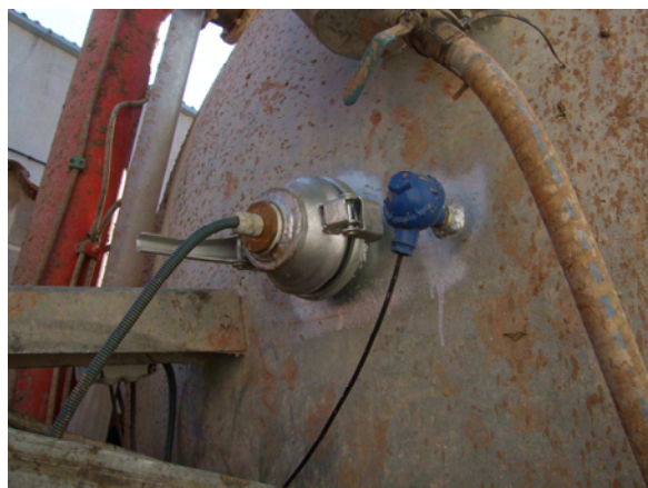
Figura 5. Sondes de conductivitat i termòmetre instal·lades a una cisterna (DARP, 2015).
