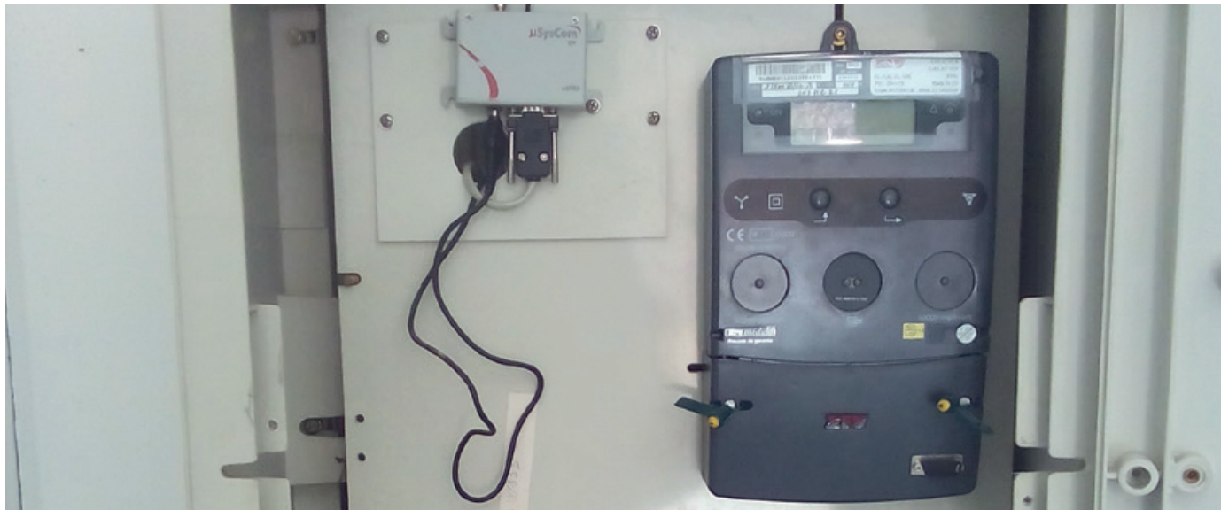
Figura 1. Comptador d'una instal·lació amb tarifa 3.1A. Font: Comunitat de Regants Segrià Sud.
