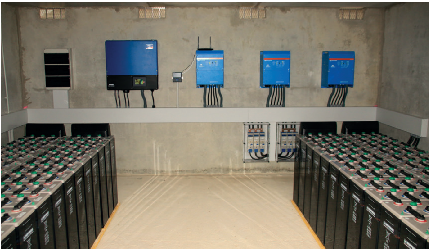
Figura 2. Caseta instrumentació elèctrica-electrònica i bateries de la instal·lació solar. Font: ASG.
