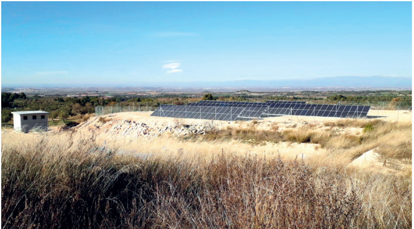
Figura 1. Planta fotovoltaica. Font: Xavier Guixà i Joan Latorre.
