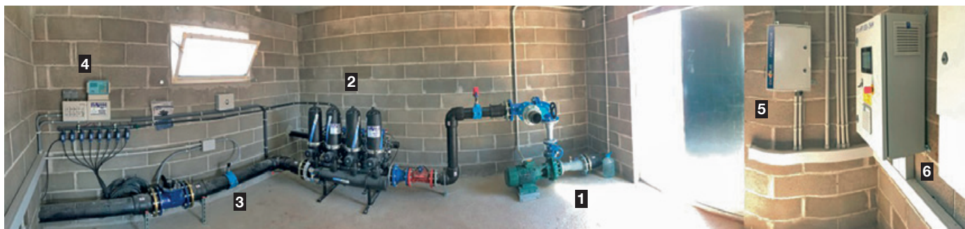
Figura 5. Capçal de reg a la finca Prat: motobomba elèctrica horitzontal (1), estació de filtratge per anelles (2), cabalímetre (3), sistema d'automatització del reg (4), quadre de proteccions (5) i sistema de control del bombament solar (6). Font: Joan Roma Velasco.
