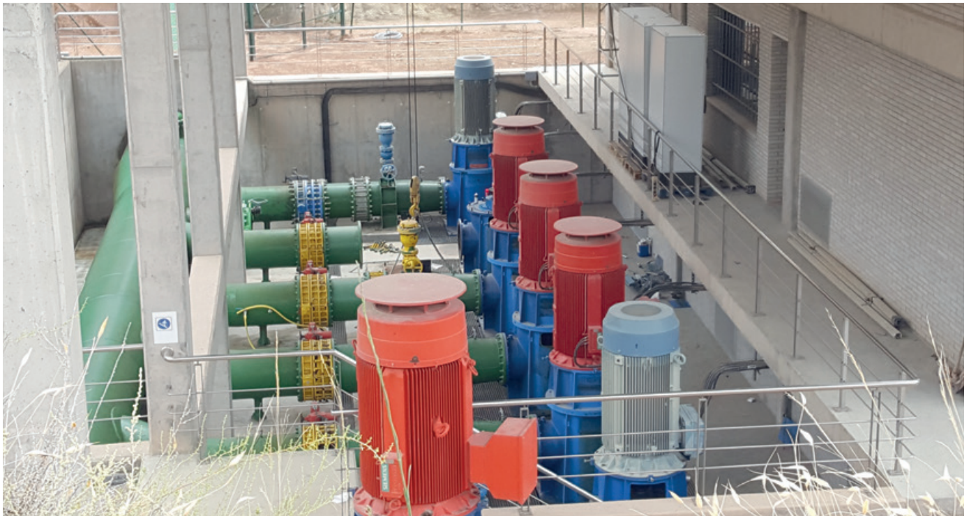
Figura 1. Estació de bombament. Font: C.T. ANTLIA, S.L.
