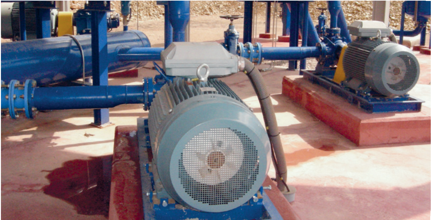
Figura 1. Estació de bombament en una Comunitat de Regants. Font: "Guia de bones pràctiques per l'eficiència energètica a les CRR".
