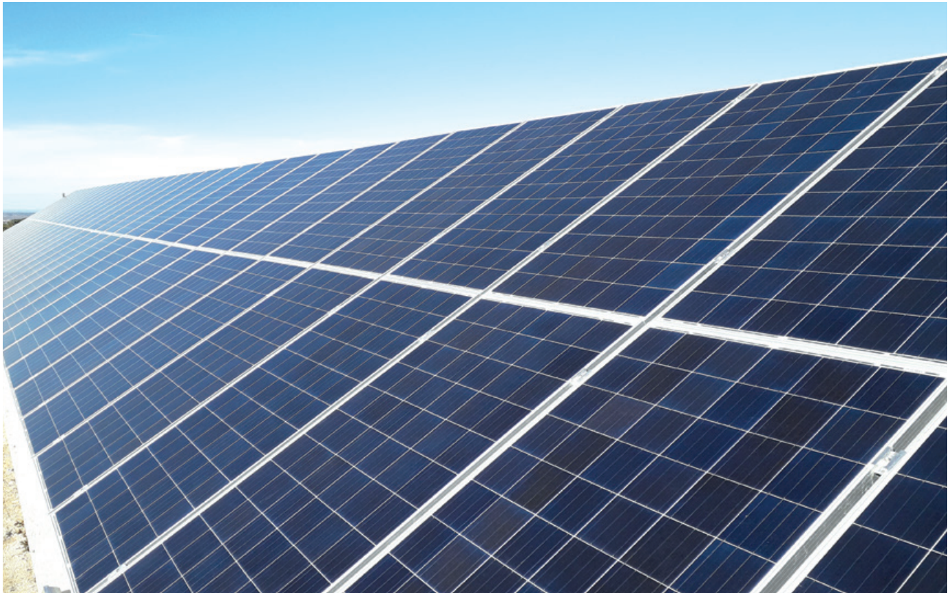
Figura 1. Plaques en camp solar de tipus fix amb inclinació a 30°. Font: Joan Latorre i Xavier Guixà.
