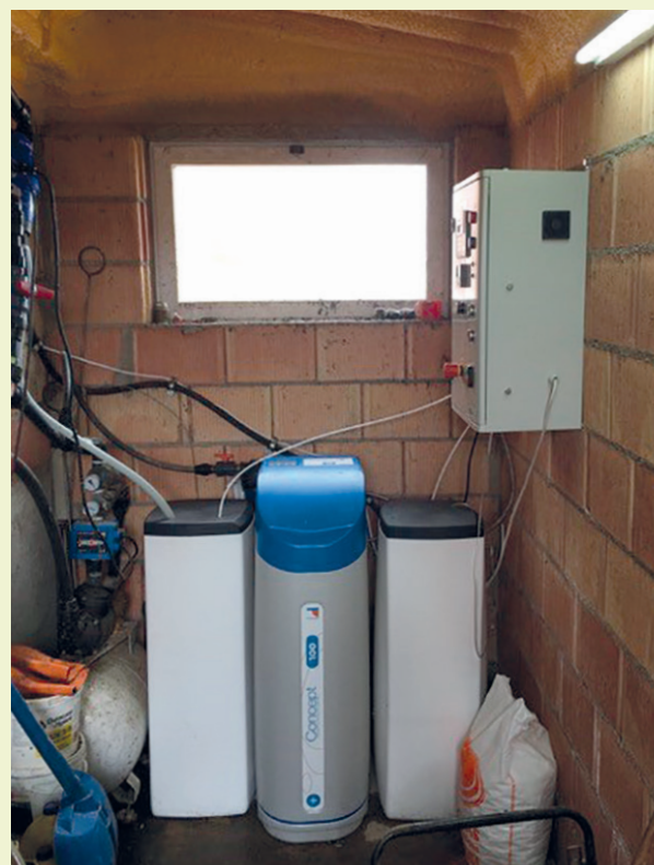
Figura 2. Instal·lació de l'equipament d'aigua electrolitzada a la granja d'engreix. Autor: Xavier Puigvert.
